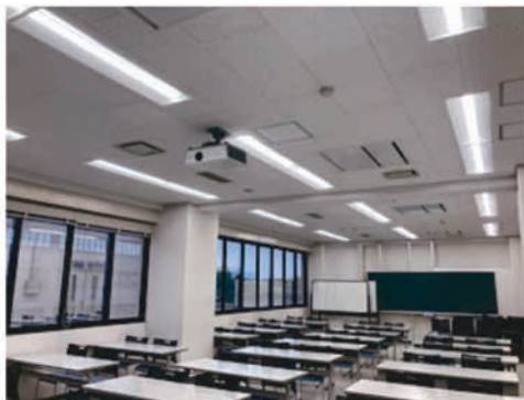
LED照明器具へ改修した建物 (2019年度 理工学部6号館 講義室)
